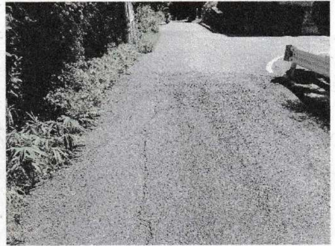
写真③ As舗装亀裂
